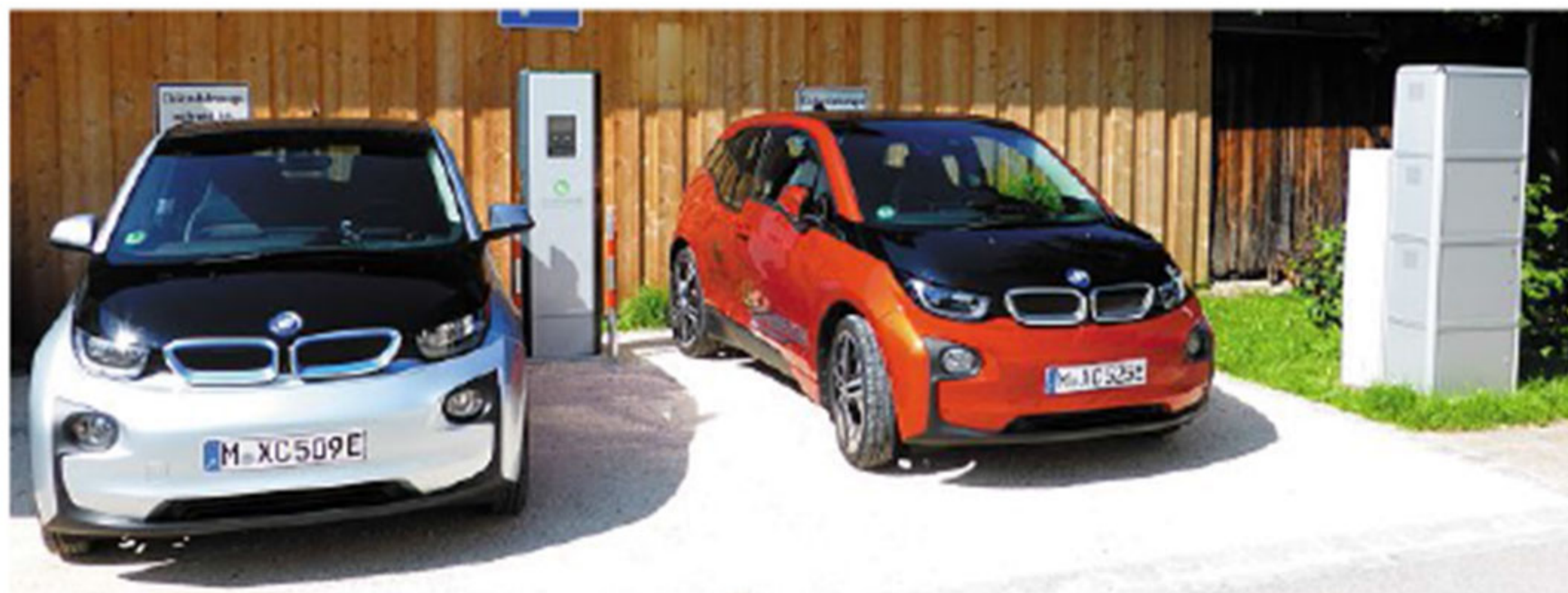
Die neue Elektroladesäule im Bereich der Tourist-Information in Grabenstätt. Daneben die verschließbaren Ladeboxen für Akkus von E-Bikes.
