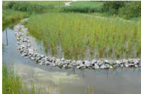
In der biologischen Kläranlage am Schotterweg zum Weiler Hofstätt dient Schilf zur Vorreinigung des Regenwassers von Straße und Feldern. (AG)
